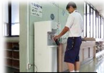
ウォーターサーバー (2・3・4F に設置)
